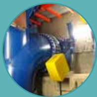
6 Centrale idroelettrica della Canonica
